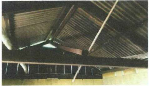
Foto 4: La estructura de techo del módulo de la cocina con soporte de madera se encuentran en mal estado que amerita sustitución por metal.
