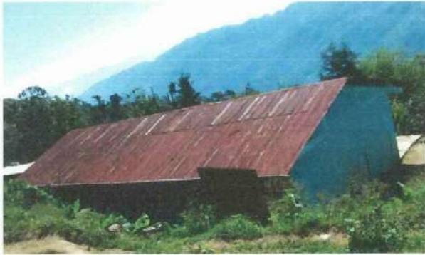
Foto 1: Cubierta de lámina del módulo de las aulas con las láminas de zinc oxidadas y deterioradas requieren sustitución por láminas troqueladas.
