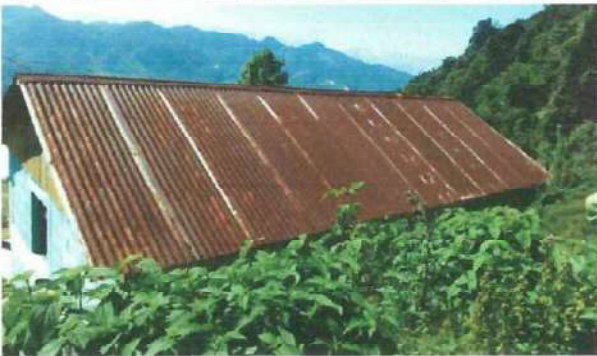
Foto 3: La cubierta de lámina del módulo de cocina se encuentra oxidada que amerita sustitución por lámina troqueada.
