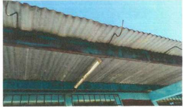
Foto 2: La estructura de soporte de metal del módulo de las aulas están oxidadas que ameritan mantenimiento.
